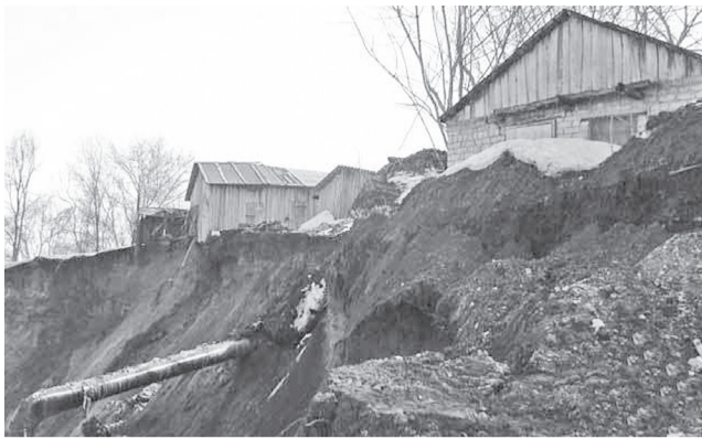
Депутаты гордумы приняли решение направить 28 миллионов 200 тысяч рублей на расселение жителей поселка Мостостроителей, чьи дома оказались в опасной близости к оползневой зоне.
